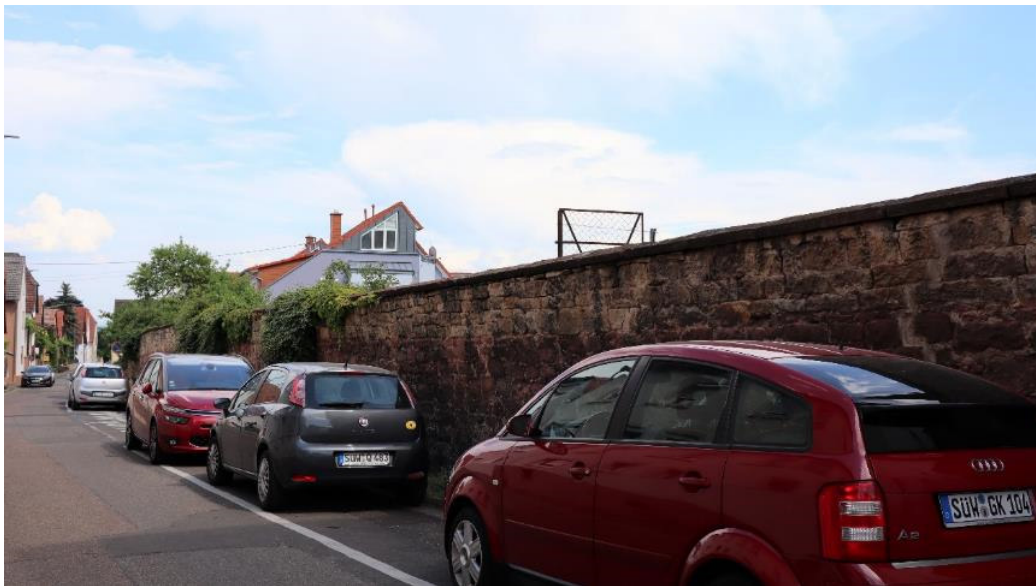
Abb. 87: Friedhofstraße 101, Umfassungsmauer des Weingartens.
