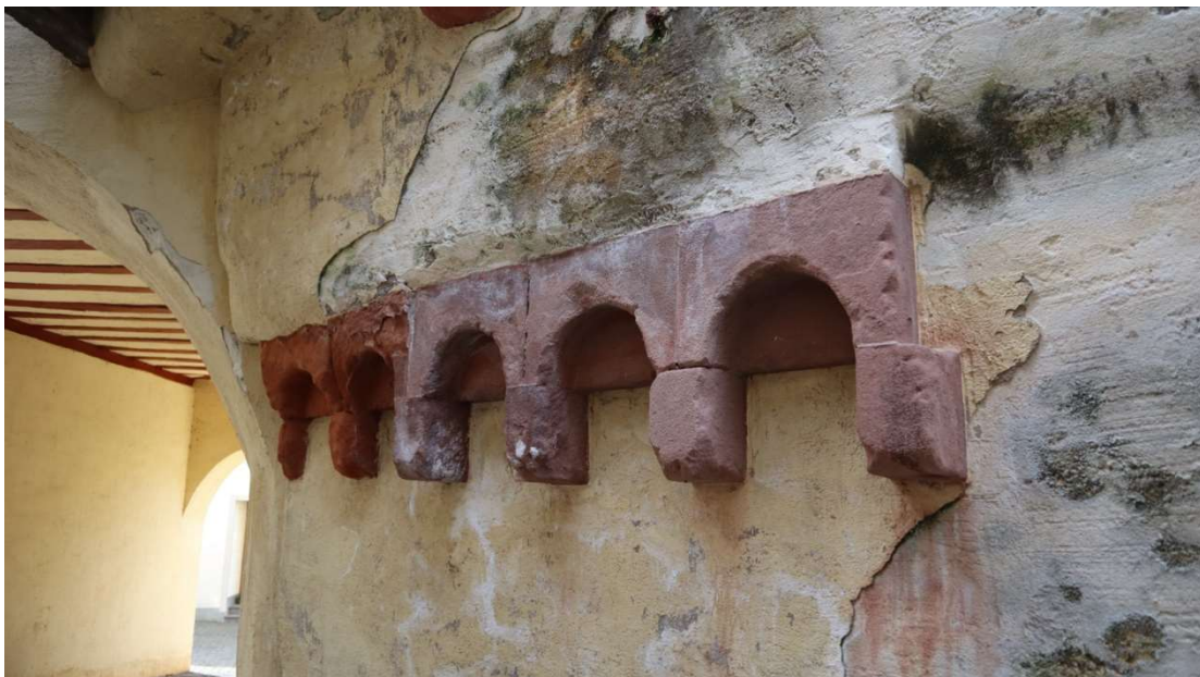
Abb. 20: Spiel- und Rathaus, Detailaufnahme rundbogiger Konsolsteine an der nordöstlichen Fassade, die eine darüber liegende Kaminleiste tragen.
