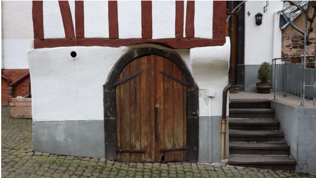
Abb. 67: Christophorusweg 4, Blick von Norden auf die Schrottür mit Basaltlava-Gewände und die Eingangssituation.
