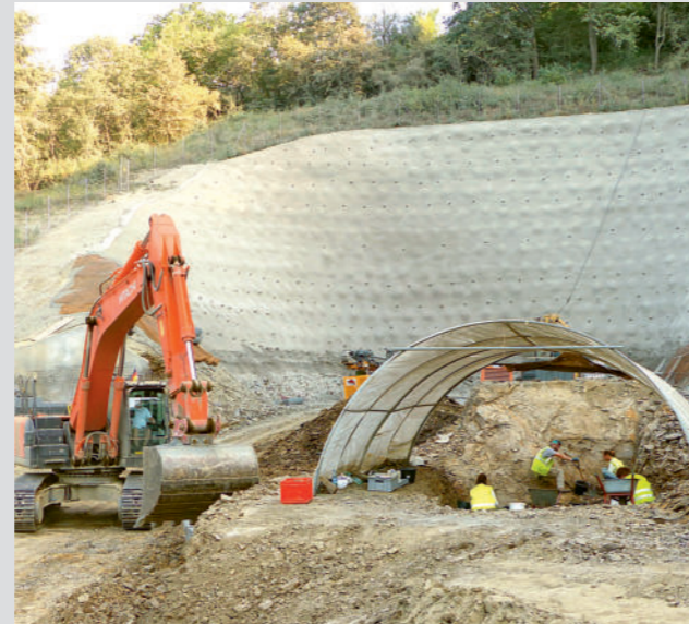
Imsweiler, Ortsumgehung 2019: Rettungsgrabung in 297 Mio. Jahre alten Seeablagerungen vor dem geplanten Tunnelportal
